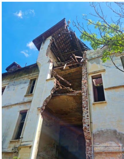
Figura 3: Pabellón deteriorado por el tiempo
