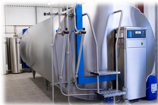
Imagen 5: Sala de enfriamiento de leche, tanque de frío GEAFARM
