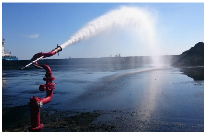
Imagen 8. Se observa el alcance del monitor
