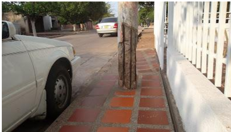
Imagen 1: Poste mal ubicado obstaculizando la circulación. Fuente: “Burradasurbanas”, 2019.
