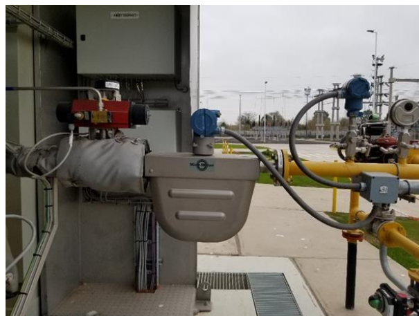
Ilustración 48 – Caudalímetros de gasoil instalados en las unidades TG6 y TG7 – fotografía extraída por el autor
