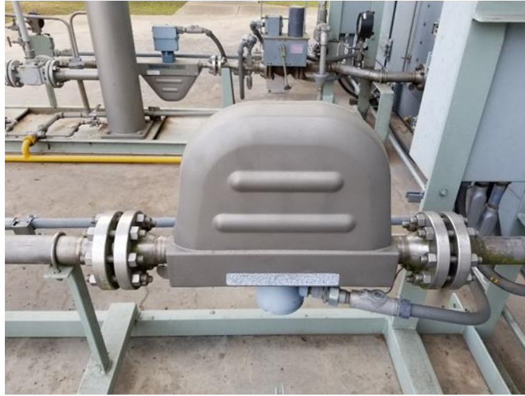
Ilustración 52 – Caudalímetros de gas natural instalados en TG3, TG4 y TG5 – fotografía extraída por el autor
