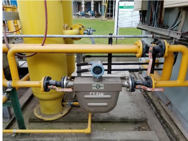
Ilustración 46 - Caudalímetros de gasoil instalados en las unidades TG1 y TG2 – fotografía extraída por el autor
