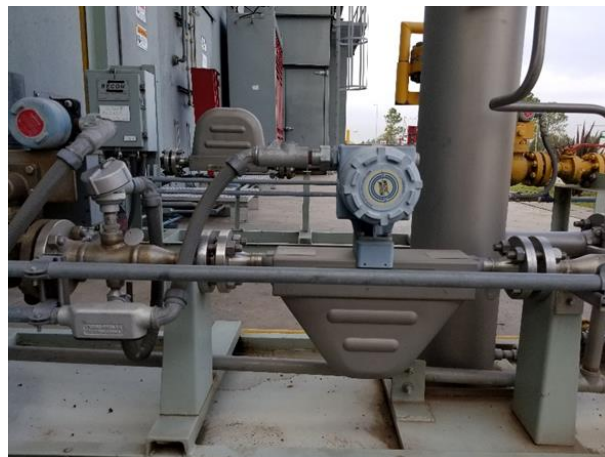
Ilustración 47 - Caudalímetros de gasoil instalados en las unidades TG3, TG4 y TG5 – fotografía extraída por el autor
