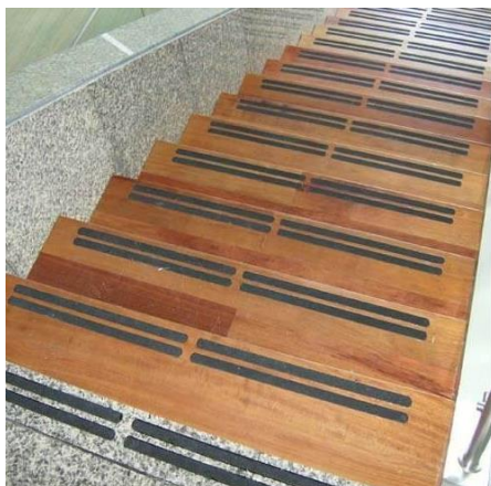
Imagen 7: Escaleras con colocación antideslizante.
