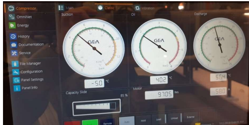
Figura 10: Foto extraída del panel de operación de compresor de propano mientras se utilizaba el economizador. Elaboración propia
