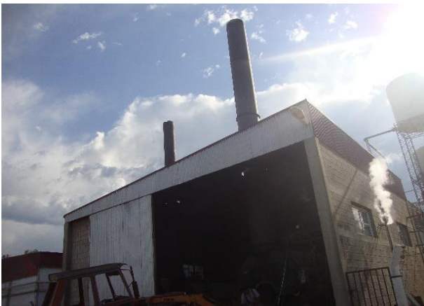
Figura 49. Chimenea de la caldera
