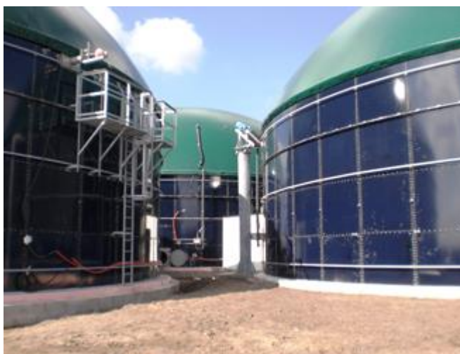
Ilustración 17: Cámara de digestión
