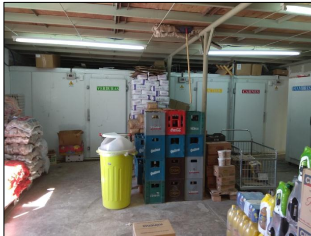
Ilustración 8 - Al fondo, Cámaras frigoríficas.
