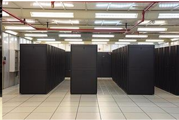
Imagen 7: Datacenter de ARSAT
