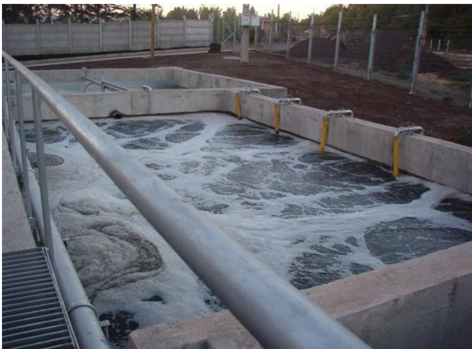
Gráfico 16 – Planta de tratamiento aeróbico de aguas residuales
