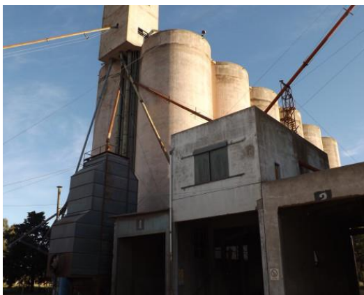
Figura 4. Silos de material.
