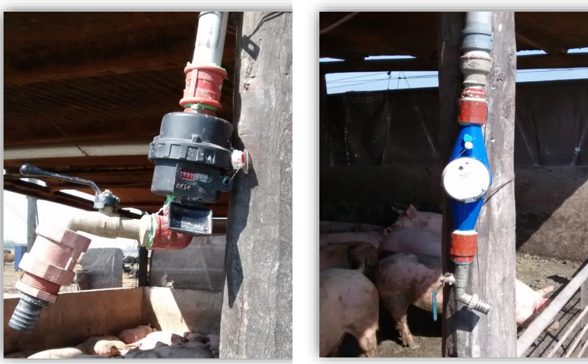
Figura 12. Vista de los caudalímetros colocados en las cañerías de lavado del galpón de engorde.
