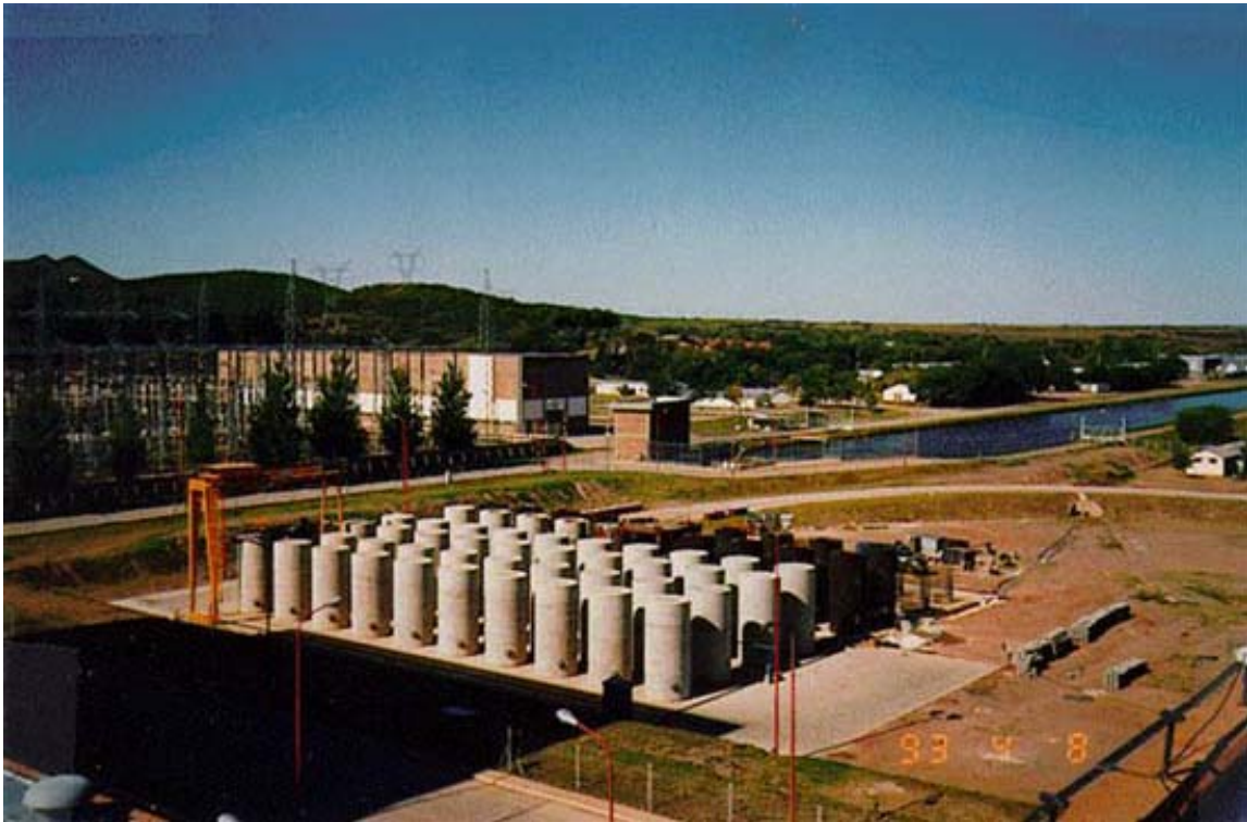
Figura N° 9: Silos de almacenamiento en seco de la CNE 25
