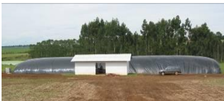
Figura 12. Gasómetro de un biodigestor de desplazamiento horizontal lleno de biogas y planta de comandos (en construcción)
