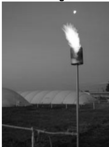
Figura 13. Mechero aéreo quemando biogas excedente
