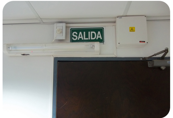
7. Señal de Salida con luz de emergencia.
