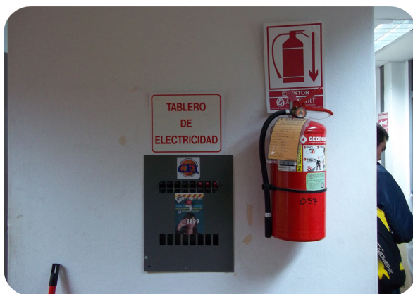
9. Extintor y llaves de corte eléctrico.
