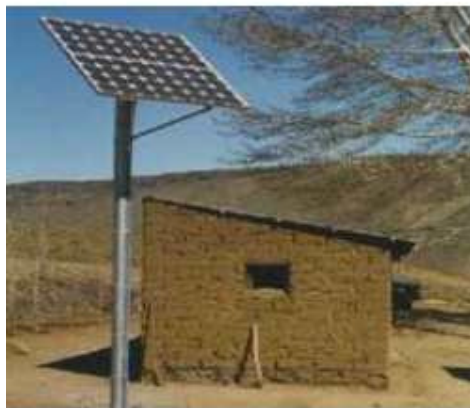
Paneles fotovoltaicos para generar energía en vivienda rural
